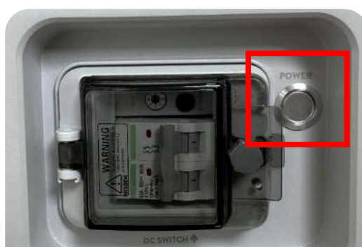
Abbildung 19: Abschalten der Batterie
